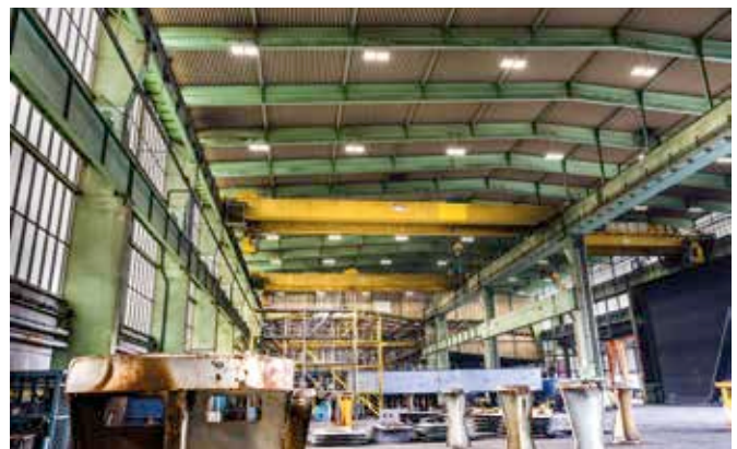
(Bildquelle: Deutsche Lichtmiete / Mario Dirks) Bildunterschrift: Beste Produktionsbedingungen im Schiffbau: Moderne LED Industrie-Hallenstrahler in der Fertigungshalle der Pella Sietas Werft
