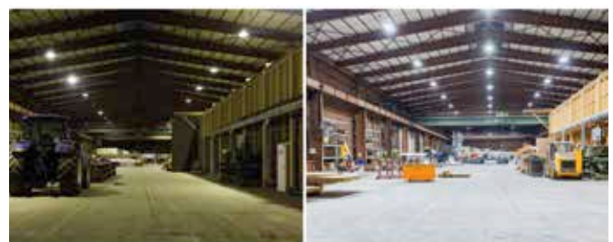
(Bildquelle: Deutsche Lichtmiete / Steffen Löffler) Bildunterschrift: Die Werkshalle vor und nach der Sanierung der Beleuchtung
