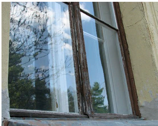
3. kép: Elavult nyílászárók E épület
